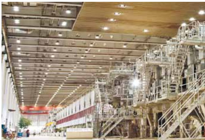
Denna pappersmaskin är ett exempel på en fast installation.
